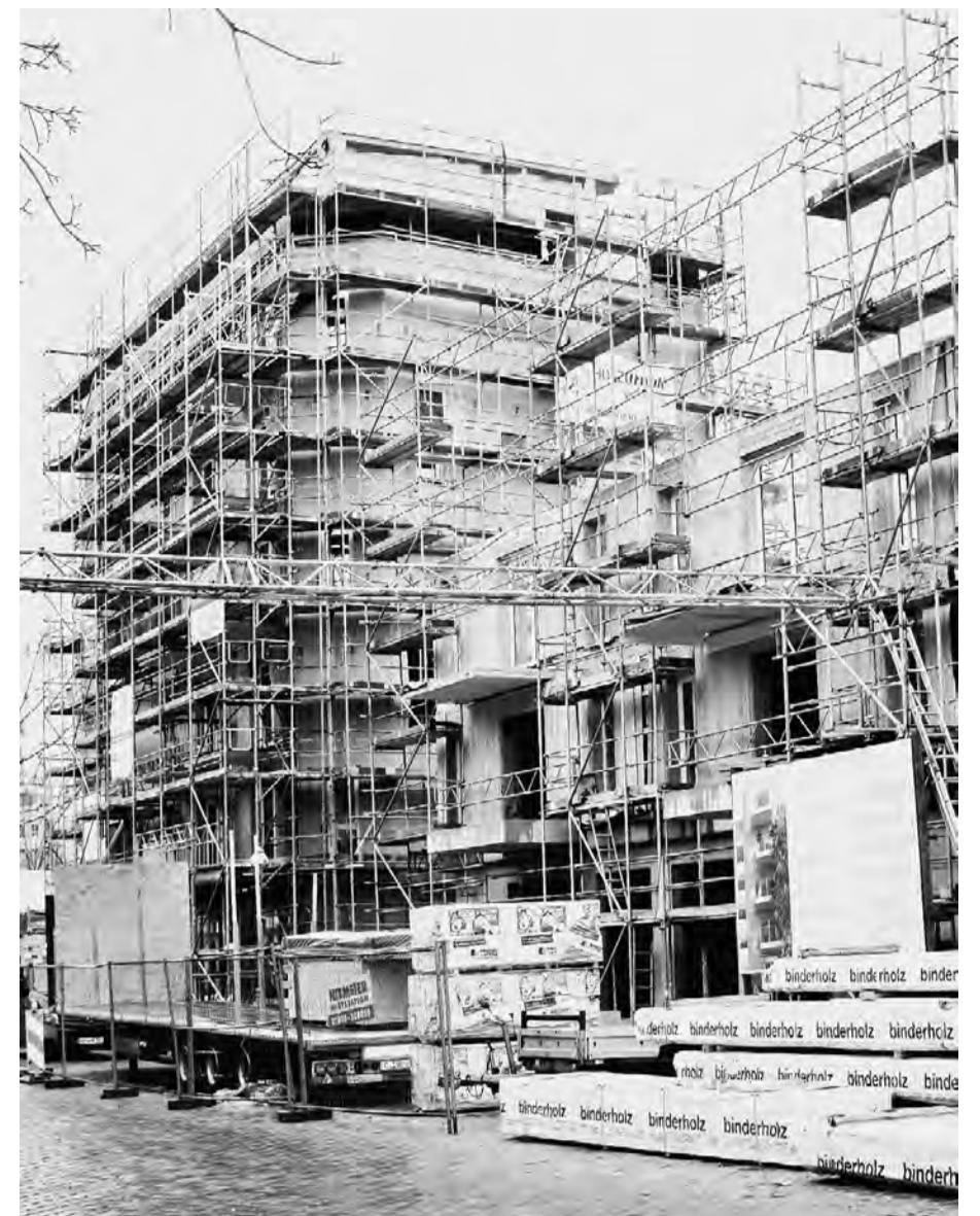
Holzbau mit sechs Vollgeschossen: Mit dem „Holzhaus Lynarstraße“ sind 93 Wohnungen und mehr als ein Dutzend Gewerbeeinheiten entstanden.
